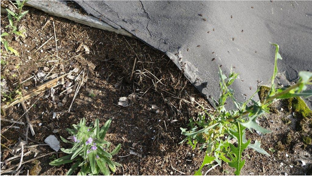
Abbildung 32 Nest von Waldameisen teilweise unter einer Dachpappe
