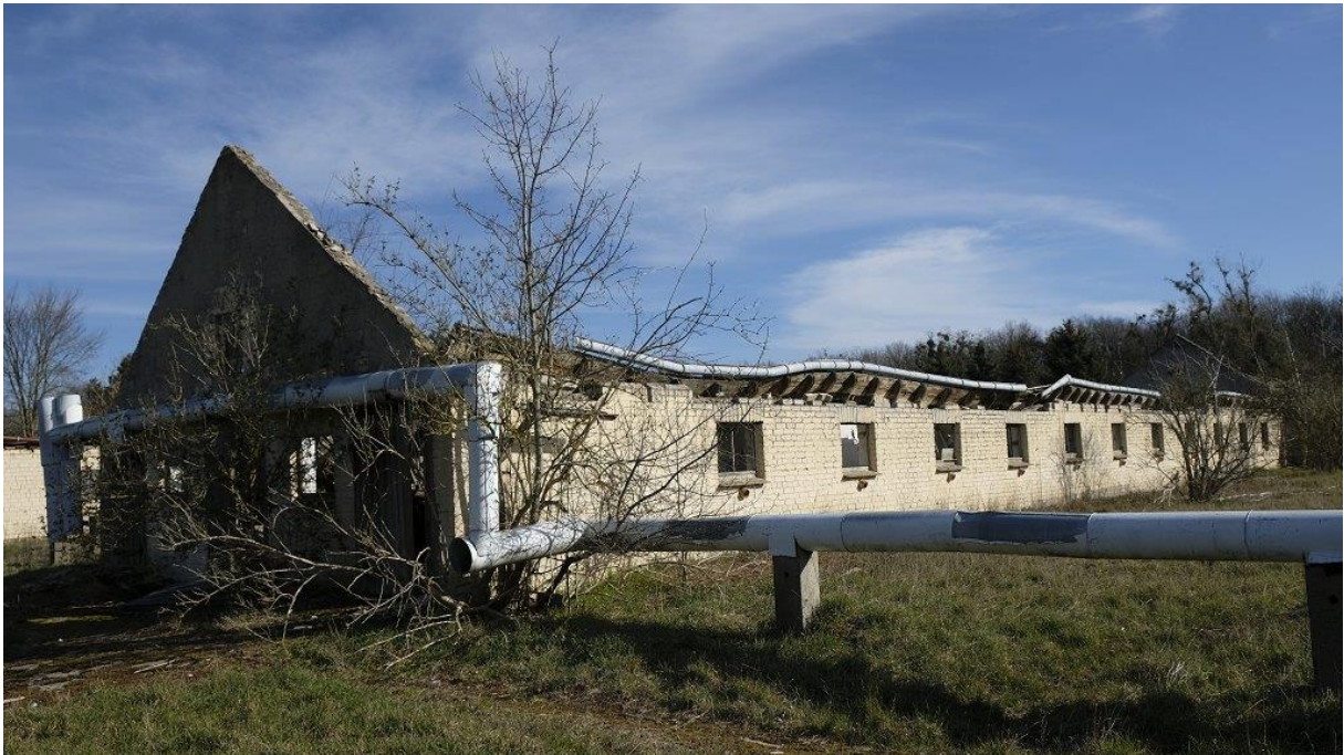
Abbildung 19 eines der eingestürzten Gebäude
